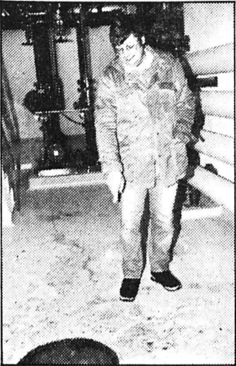
Le responsable de la STEP, M. Kurt Zingg, montre la fissure située juste avant la chambre d'eau où il a percé quelques trous pour que l'eau trouve un passage et ne se répande pas dans le sous-sol abritant les machines. (photo vu)
