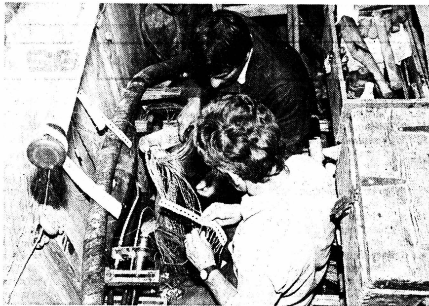
Une chambre à câbles de l'avenue de la Gare. 5400 heures de travail pour raccorder le nouveau central. (Photo Gruber)
