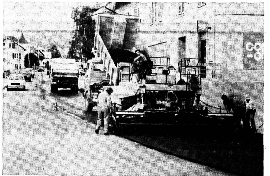
Dans la série des grands feuilletons de l'été, celui des travaux routiers vient de s'enrichir d'un nouvel épisode, puisqu'à Fontainemelon l'axe principal - l'avenue Robert - s'est doté en cette fin de semaine d'un revêtement flamboyant neuf. Un tapis de bitume de 35 mm. d'épaisseur qui permettra de rouler à 50 km/h. avec un confort sans pareil... (Photo Impar - ms)
