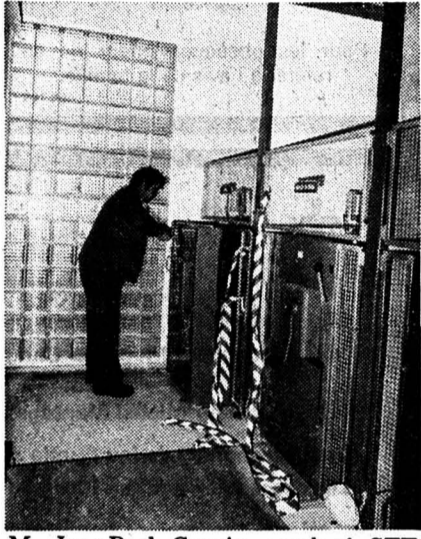
M. Jean-Paul Guenin, employé STT, occupé au réenclenchement d'un disjoncteur semblable à celui qui a provoqué l'explosion.
