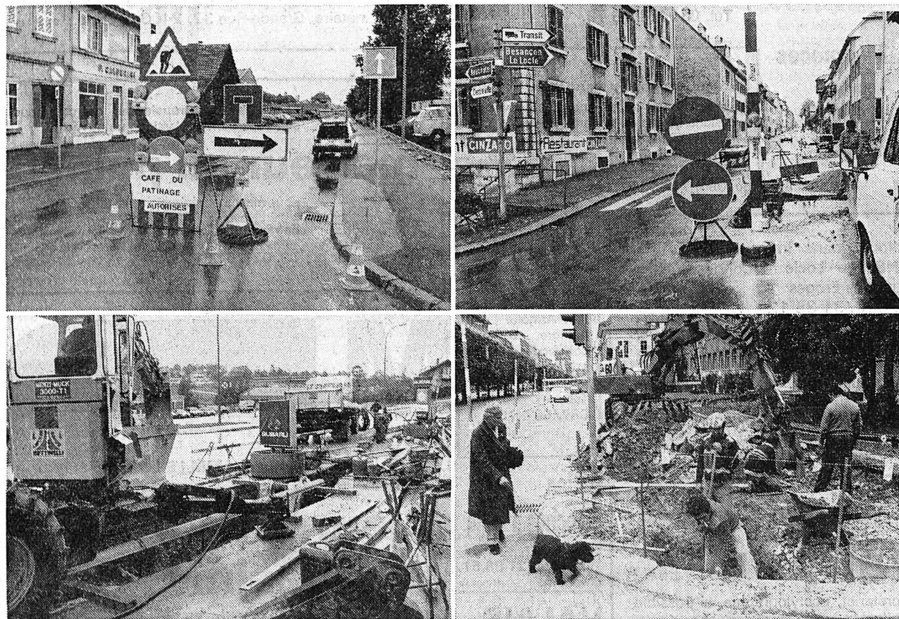
En haut à gauche, le barrage qui interdit l'accès au chantier Collège-Marais, franchi par plus de la moitié des automobilistes; à droite, le carrefour Versoix-Numa-Droz; en bas à gauche, les travaux sur la rue Fritz-Courvoisier; à droite, ceux entrepris sur l'artère sud du Pod. (photos Bernard)
