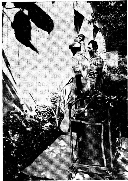
Un compresseur, une buse de mélange, un pistolet, un tuyau, de la mousse: de quoi isoler un immeuble. (photo Impar-RWS)
