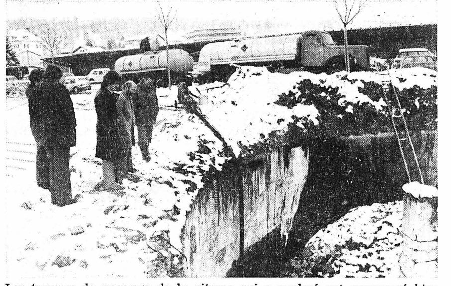
Les travaux de pompage de la citerne qui a explosé ont commencé hier matin. (photo Impar-Bernard)
