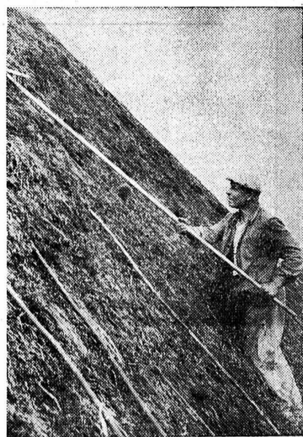
Après la mort du « couvreur en chaume » Albert Mattenberger, il ne reste qu'un seul couvreur en Suisse pour couvrir les quelques toits de chaume qui restent. C'est Joseph Schenker, qui vit près de Däniken. C'est à l'Exposition nationale de Zurich (1939) qu'on vit le chef-d'œuvre de Joseph Schenker, la « Fischerstube » qui comprenait 2000 m 2 de toit en chaume.
