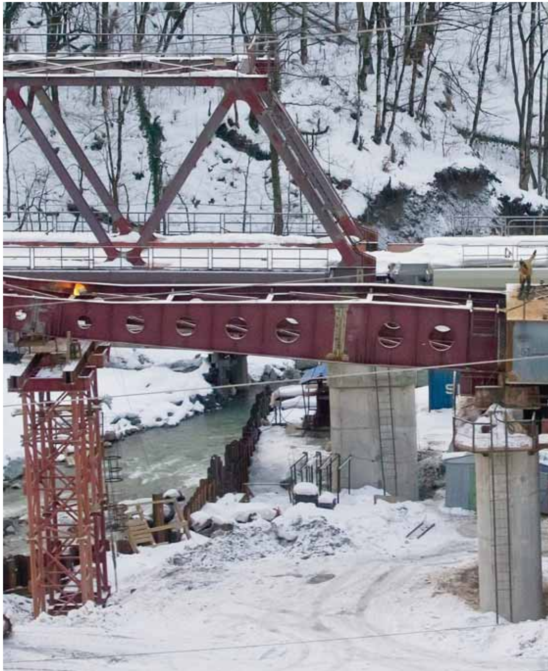
Les travaux de la liaison rapide (route et rail) entre l'aéroport de Sotchi et Krasnaya Polyana engendrent un chantier pharaonique. KEYSTONE
