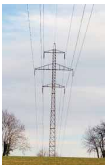
Selon Swissgrid, les techniques actuelles plaident en faveur des lignes aériennes pour la très haute tension. ARCHIVES DAVID MARCHON
