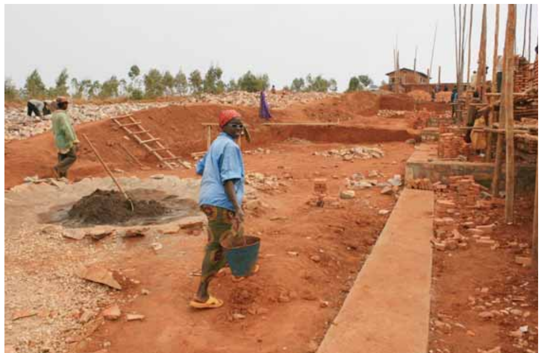
Début de la construction du centre de formation en hygiène et assainissement à Mugeru en 2008. SP
