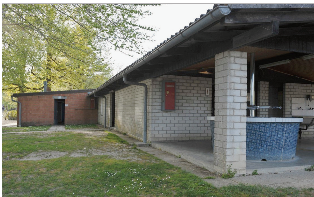
RESTAURATION Les sanitaires actuels sont vétustes et attaqués par l'humidité. Ils seront reconstruits et permettront au camping de passer de trois à quatre étoiles.
