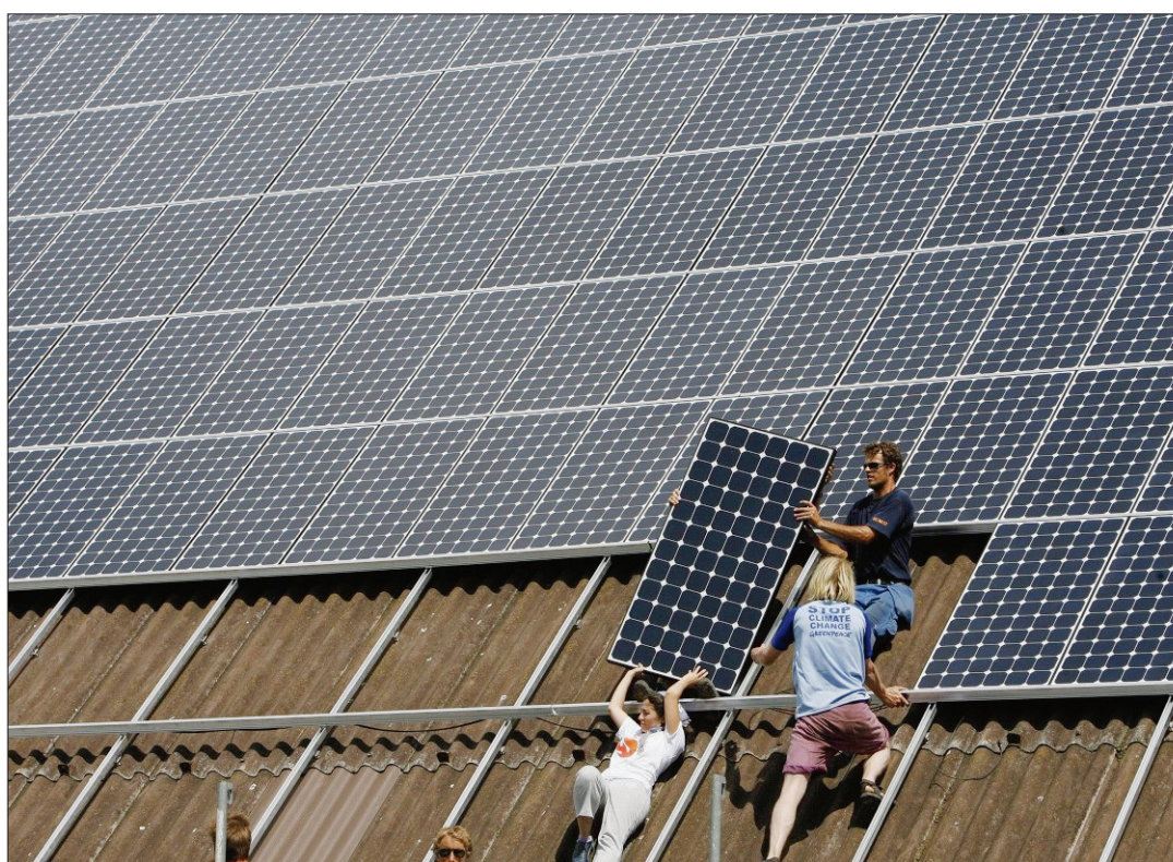
CAPTEURS Toute nouvelle construction devra en comporter si la révision de la loi sur l'énergie est acceptée ce printemps par le Grand Conseil.
