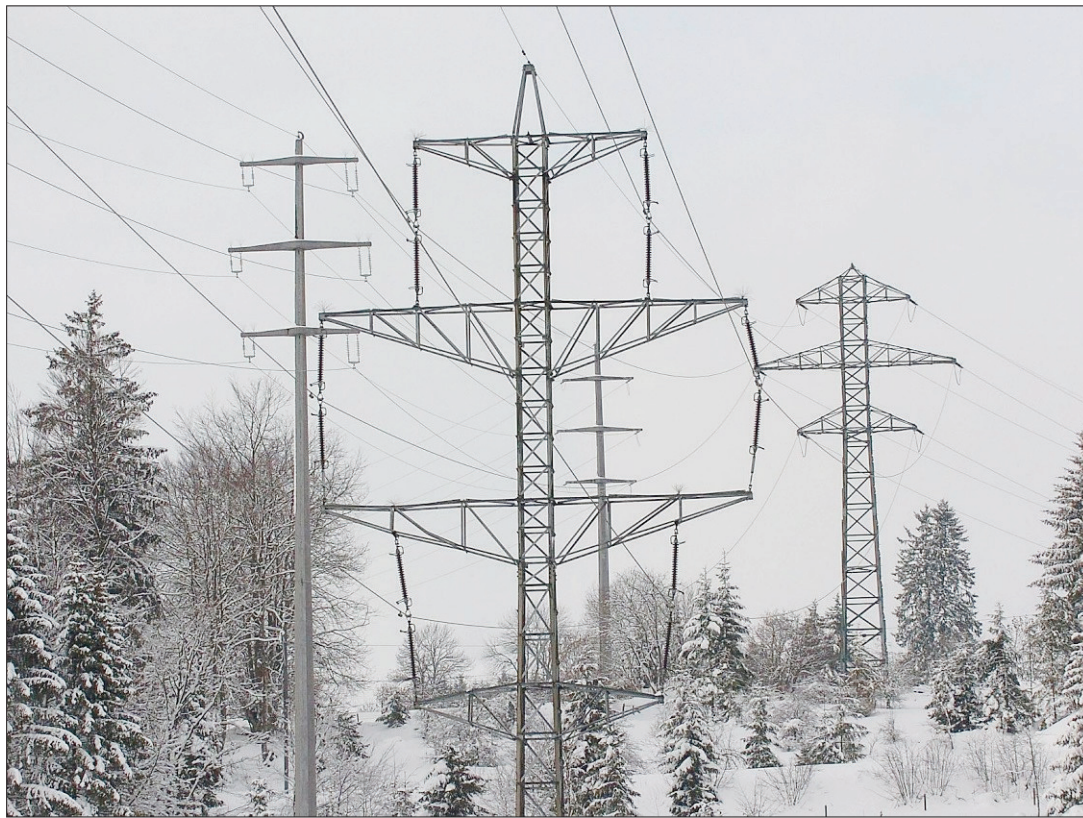
LIGNES À HAUTE TENSION La baisse des coûts du transport de l'électricité sur le réseau haute tension devrait réduire de moitié la hausse annoncée des tarifs pour les consommateurs. (ARCHIVES RICHARD LEUENBERGER)
