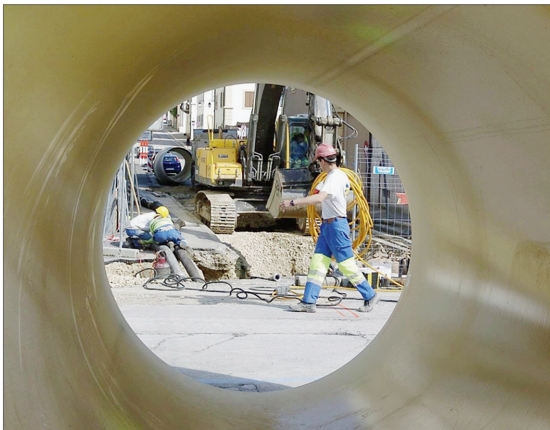
RUE DU 1ER-MARS En ligne de mire, le trou où sera posée une section de collecteur. (RICHARD LEUENBERGER)
