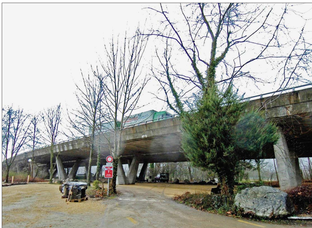
VIADUC En fort mauvais état, ce tronçon d'autoroute, d'où de petits morceaux de bitume se détachent, doit absolument subir des réfections dans les années à venir.
