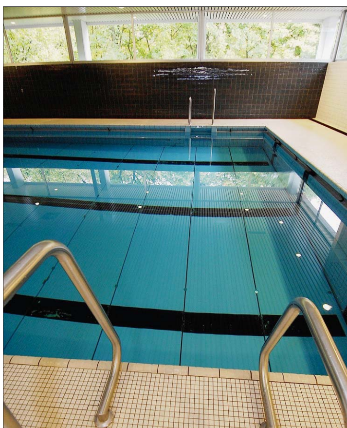
CURE POUR LE BASSIN Le fond mobile de la piscine du Mail est une particularité qui date de 1973. Imprégné d'eau, il sera rénové l'été prochain.
