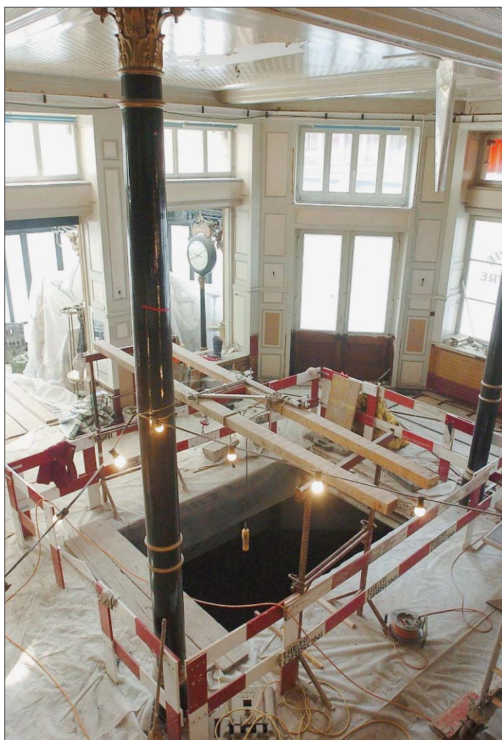
TRANSFORMATION La brasserie du Théâtre est en plein chantier. Douze cuves de bière y seront installées la semaine prochaine. (RICHARD LEUENBERGER)
