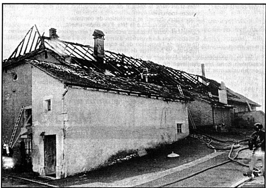
FAÇADE NORD-EST — Le grenier, plein de foin, a pris feu et les flammes se sont propagées à l'ensemble de la toiture.
