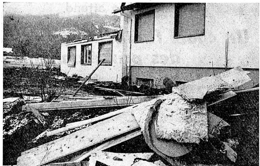
La villa de M. Vetterli vue de la route. L'aile du fond n'a plus que les quatre murs.
