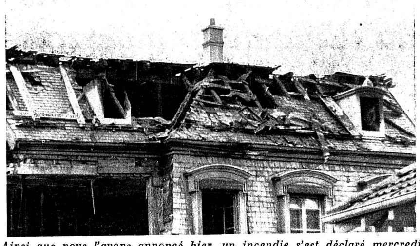
Ainsi que nous l'avons annoncé hier, un incendie s'est déclaré mercredi après-midi dans les combles de l'immeuble No 19 du faubourg de l'Hôpital, à la suite d'une imprudence d'un ouvrier soudeur. Notre photo montre l'étendue des dégâts causés à la toiture de l'immeuble. Rappelons que deux lances ont été mises en action par les pompiers qui, après 25 minutes d'effort, purent maîtriser le sinistre.
