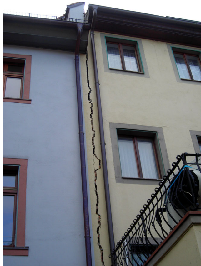
Abb. 3 In der historischen Altstadt Staufens wurden über 250 Häuser durch Hebungen des Untergrunds beschädigt. Die Hebungen wurden ausgelöst durch die Installation von Erdwärmesonden, welche zu Gebirgsquellen im darunterliegenden Gipskeuper geführt hat
