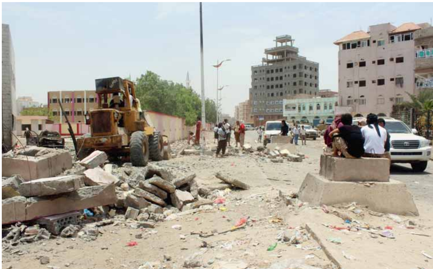
La déflagration a été si forte qu'elle a provoqué l'effondrement d'un toit sur la tête de nombreuses recrues, a précisé un responsable de sécurité. KEYSTONE
