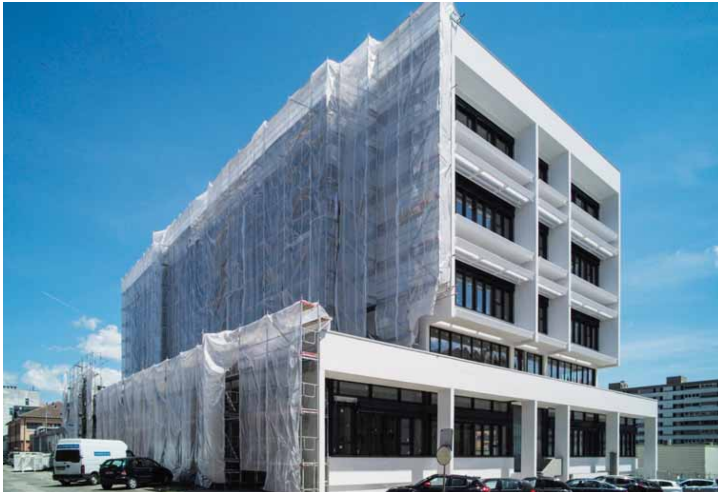
L'ancien fleuron industriel chaux-de-fonnier est en rénovation depuis plusieurs mois. A terme, il devrait accueillir diverses entités, comme un data center du Service informatique cantonal, les activités ambulatoires du Centre neuchâtelois de psychiatrie et d'autres. CHRISTIAN GALLEY
