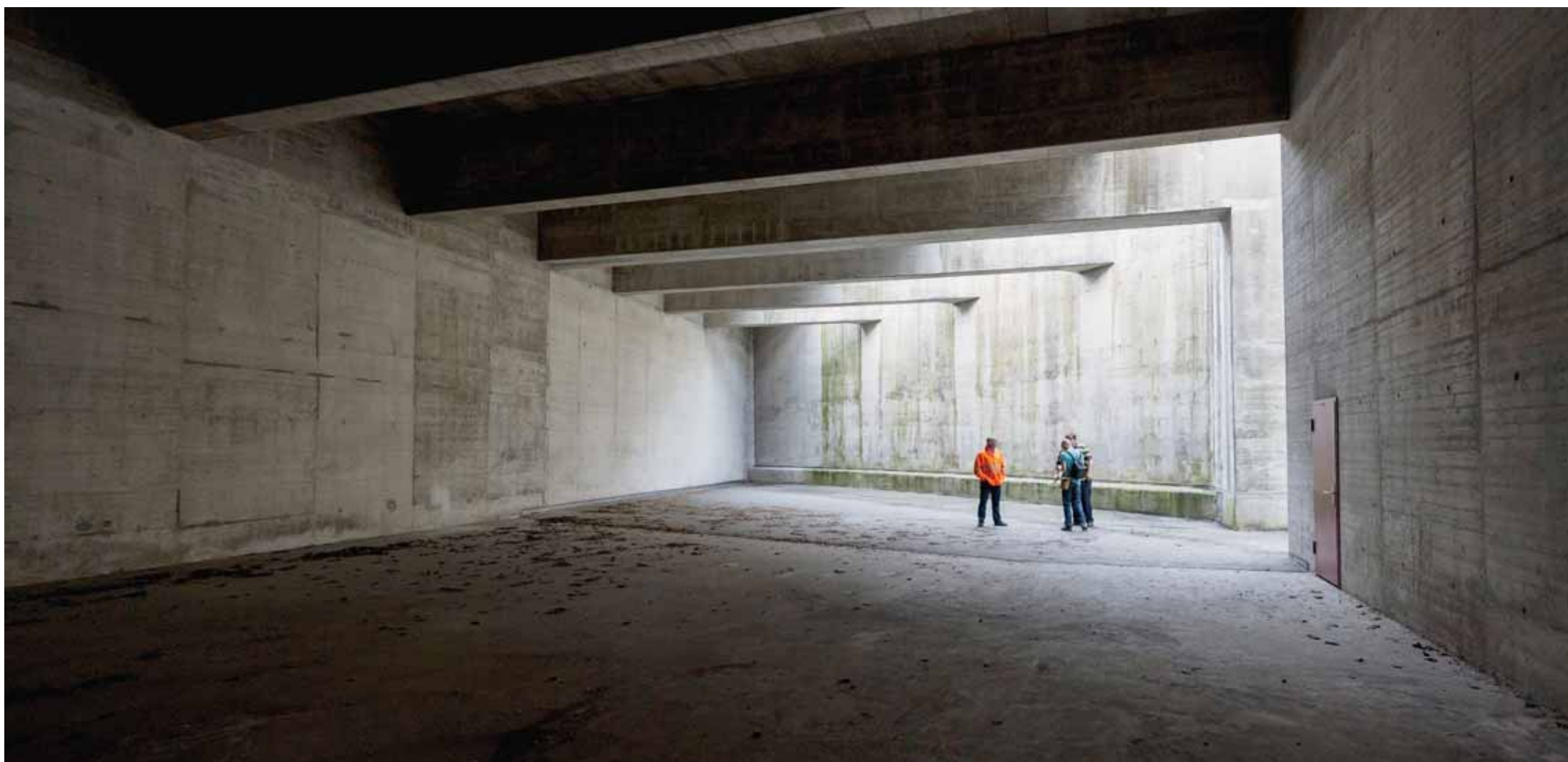
Dans la centrale du Nid-du-Crô, un vaste espace fait office de prise d'air à un ventilateur de cinq tonnes. Celui-ci sert à réguler le flux d'air et à contrôler ainsi les fumées en cas d'incendie dans les tunnels.
