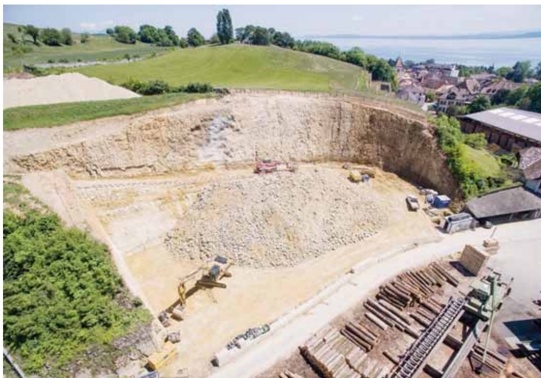
Sur le site de la future chaufferie, l'impressionnant chantier a pris du retard. LUCAS VUITEL
