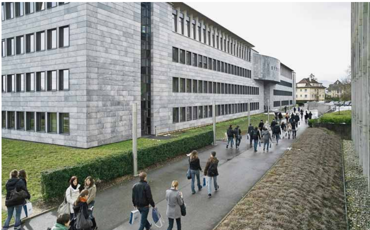
Les plaques de marbre blanc-bleuté de Savoie tombent des façades d'Unimail... Le bâtiment a déjà fait l'objet de deux assainissements. Il en faudra un troisième, qui coûtera 4,5 millions de francs et comportera la pose de panneaux solaires sur certaines façades. ARCHIVES GUILLAUME PERRET
