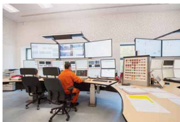
La salle de contrôle ultramoderne de la raffinerie de Cressier. LUCAS VUITEL
