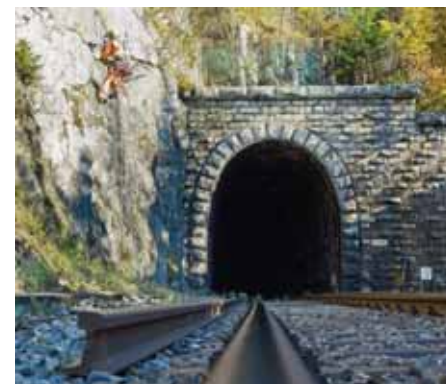
Le tunnel des Loges attend de gros travaux. ARCHIVES GUILLAUME PERRET
