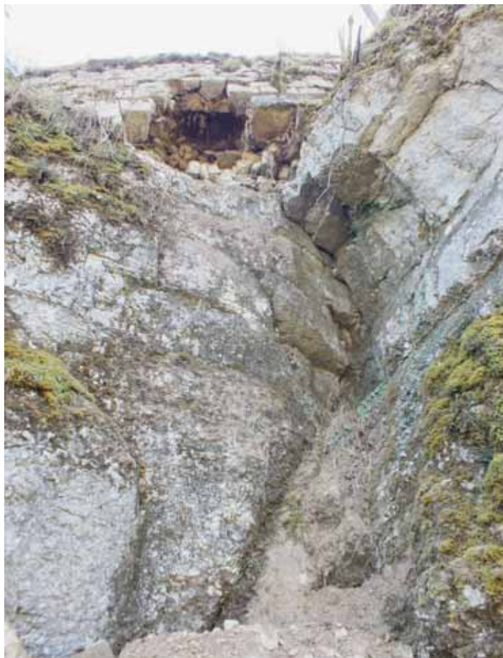
Sur le cliché pris par la commune du Noirmont, on voit bien l'état du mur de soutènement sous la route. Elle a dû être sécurisée. SP
