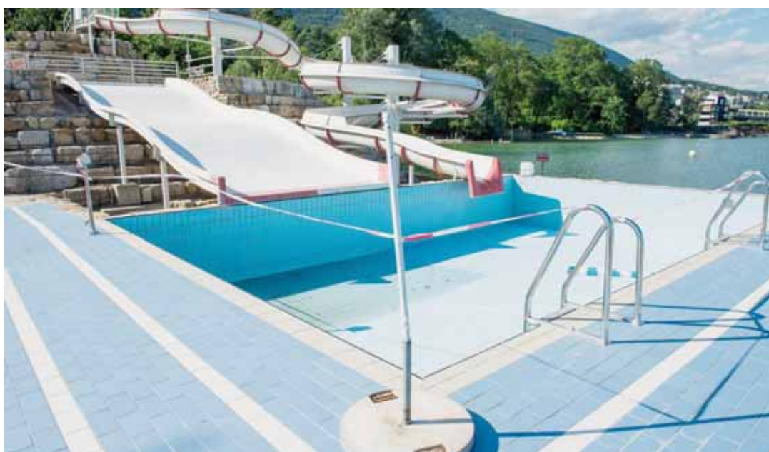
Avec les crues, l'eau du lac s'est introduite jusque sous la structure des toboggans. LUCAS VUITEL
