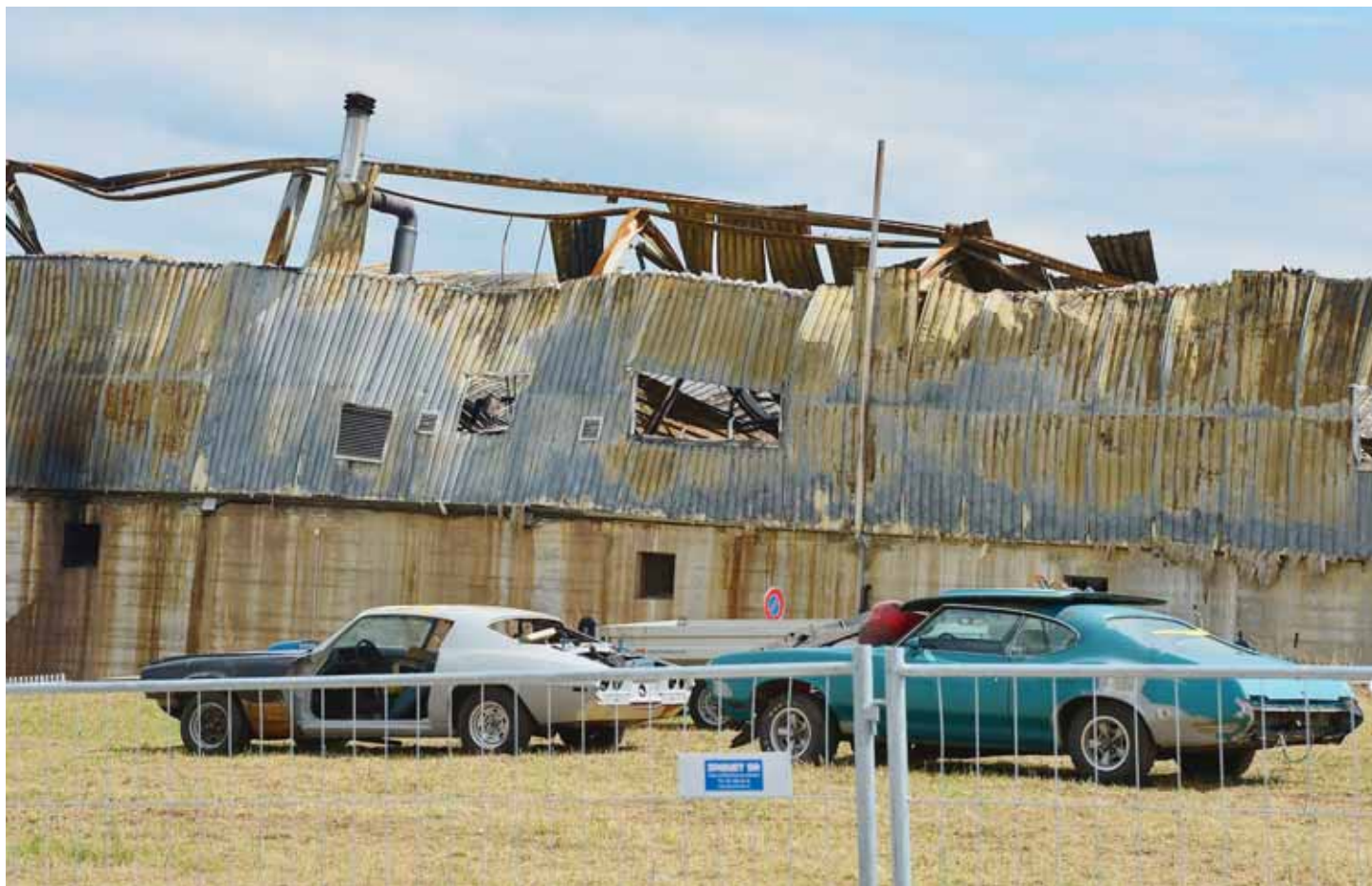
Quelques jours après l'incendie, les locataires et sous-locataires de l'entrepôt sinistré ont commencé à faire l'inventaire des pertes subies lors de ce désastre. Celles-ci sont estimées entre 20 et 25 millions de francs, bâtiment compris. ARCHIVES RICHARD LEUENBERGER
