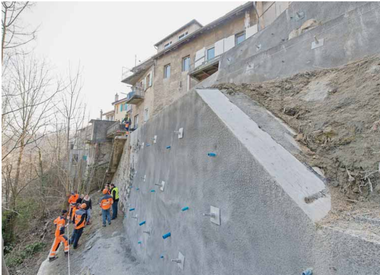
Quarante-huit tiges d'ancrage de six à quinze mètres de long ont été enfoncées dans le terrain pour le sécuriser. DAVID MARCHON
