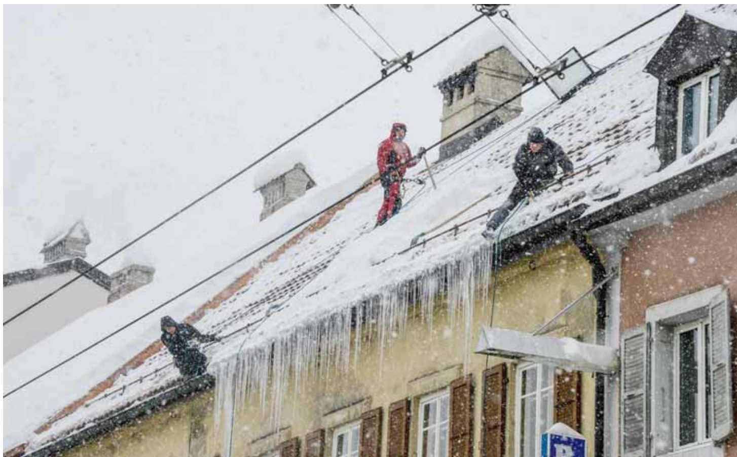
Des couvreurs en pleine action hier sur le toit d'un petit immeuble du Pod. Les glaçons qu'on voit sont de petites épées par rapport à d'autres en ville qui font plusieurs mètres de long et parfois autant de large. CHRISTIAN GALLEY
