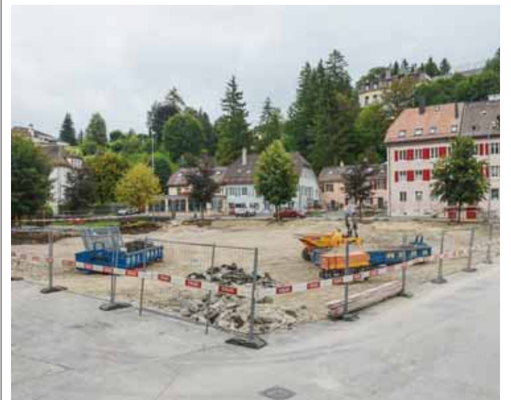
Des traces d'hydrocarbures, de plomb et de zinc ont été découvertes dans le sous-sol de la place James-Guillaume. CHRISTIAN GALLEY
