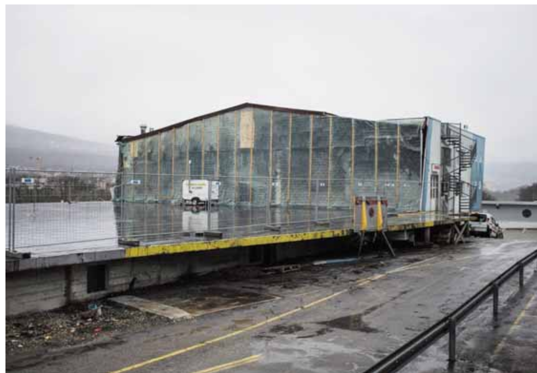
Une partie de la dalle doit être remplacée avant la construction des nouveaux entrepôts. CHRISTIAN GALLEY
