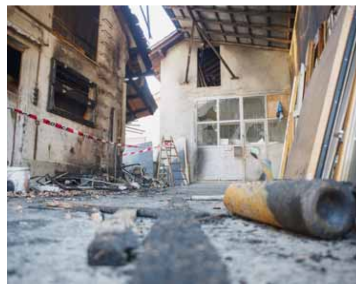
L'intérieur du hangar est noirci et le toit fortement endommagé. Mais personne n'a été blessé. DAVID MARCHON
