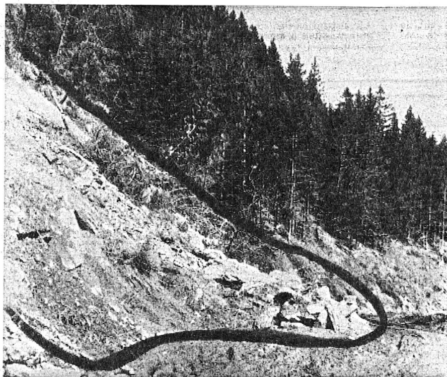
Entourés d'un trait noir, la coulée, qui n'a rien de catastrophique. Evidemment, le service des ponts et chaussées devra résoudre, si ce n'est déjà fait, le maintien de cette masse, à flanc de côteau. Vue prise côté aval.
