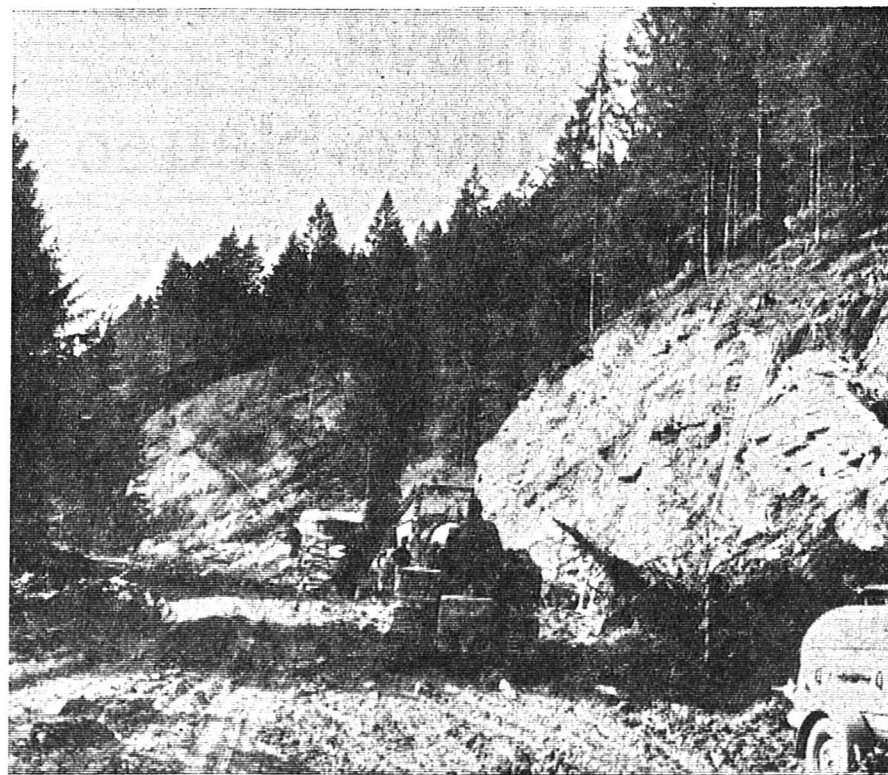
La correction du tracé de la route dans la forêt du Lézat, vue prise côté amont. Dans le cercle, la coulée en question.
