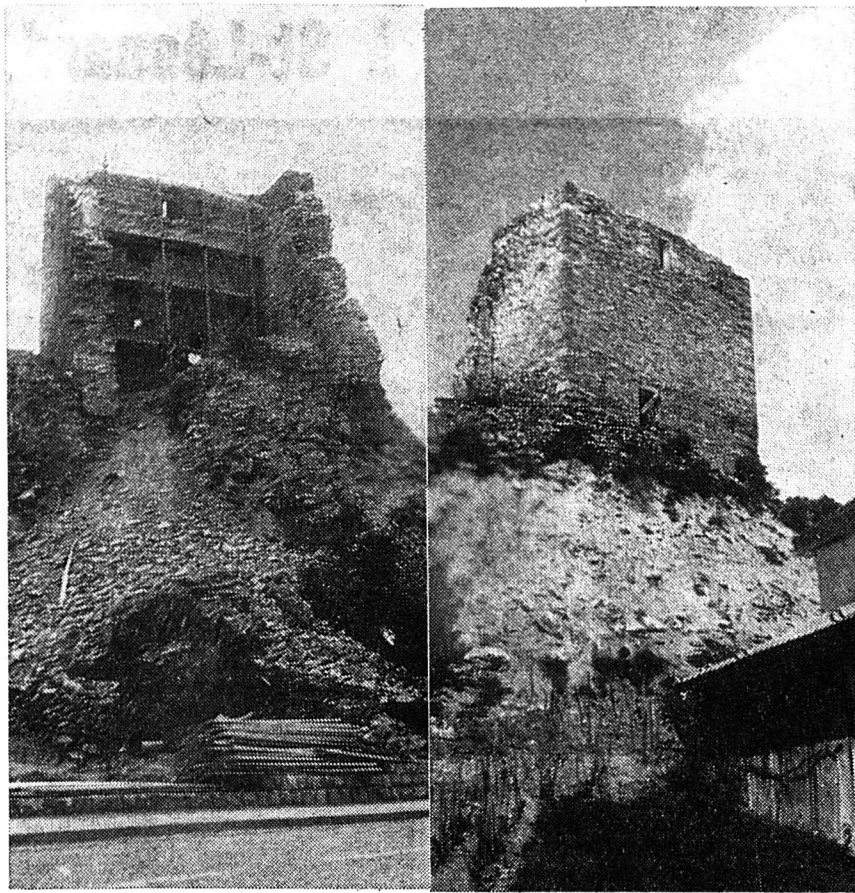
La Tour de Bozon a dominé le village de Chalais pendant des siècles et fut au moyen âge la demeure des Seigneurs. Aujourd'hui la Tour se voit appelée à être démolie partiellement. (Photos a.l.)
