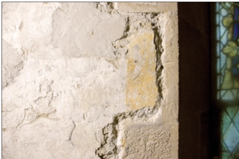
Fig. 6. Reste d'un crépi d'origine avec badigeon ocre en bordure de pierre. La prise de vue en lumière frisante met bien en valeur le piquage des crépis en bordure de la pierre effectué lors de la rénovation de 1908 (Atelier Muttner).
