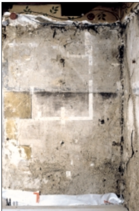
Fig. 15. Salle de justice , paroi ouest, côté nord, mai 1999. Phase préliminaire d'interventions: campagne de sondages consécutive à la suite de la suppression des panneaux installés au XX e siècle. Découverte d'une inscription et d'encadrements délimitant un faux appareil et la partie inférieure d'un registre.
