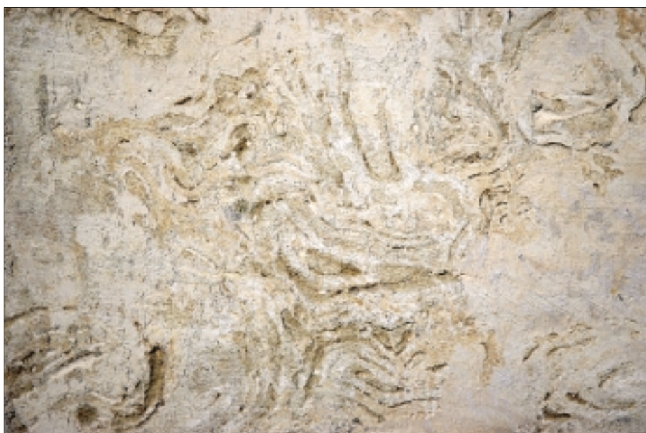
Fig. 4. Vue de l'état de dégradation d'un reste de crépi gothique conservé sur la paroi occidentale du chœur (Atelier Muttner).
