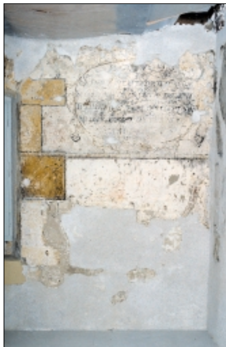
Fig. 16. Salle de justice , paroi ouest, côté nord, septembre 2000, complément à la fig. 15. Travaux en cours: suppression des badigeons, consolidation et fixage des enduits, mise au jour des décors peints et des inscriptions, première couche d'enduit appliquée sur les manques.
