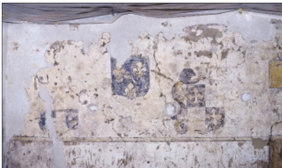
Fig. 18. Salle de justice , paroi ouest, côté sud, septembre 2000. Travaux en cours. Suppression des badigeons; consolidation et fixation des enduits; mise au jour des décors peints et des inscriptions; première couche d'enduit appliquée sur les manques et des lacunes.
