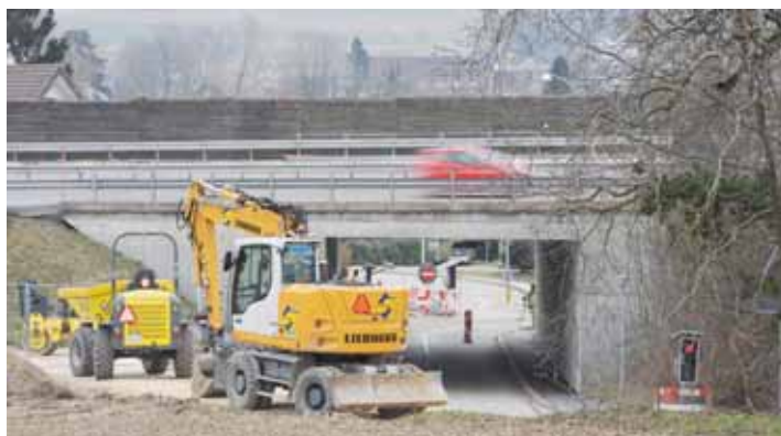
La phase préparatoire des travaux de rénovation complète du tronçon entre Saint-Blaise et Cornaux vient de débuter avec l'assainissement des passages inférieurs, ici à la hauteur de Thielle. CHRISTIAN GALLEY
