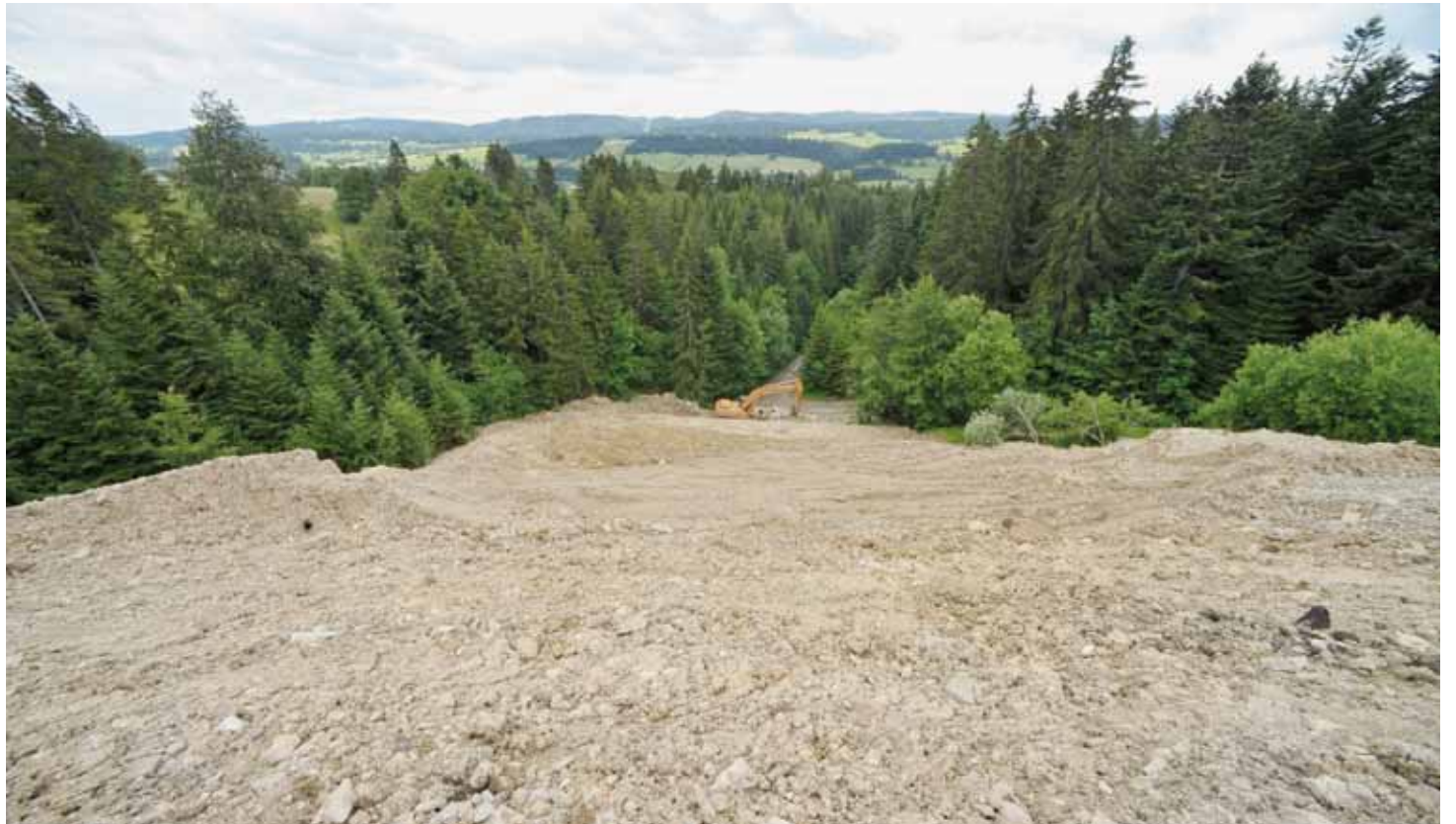
Prise hier du haut du talus formé par les matériaux de comblement, cette image montre le travail effectué cette semaine par l'entreprise responsable pour alléger la partie centrale. CHRISTIAN GALLEY
