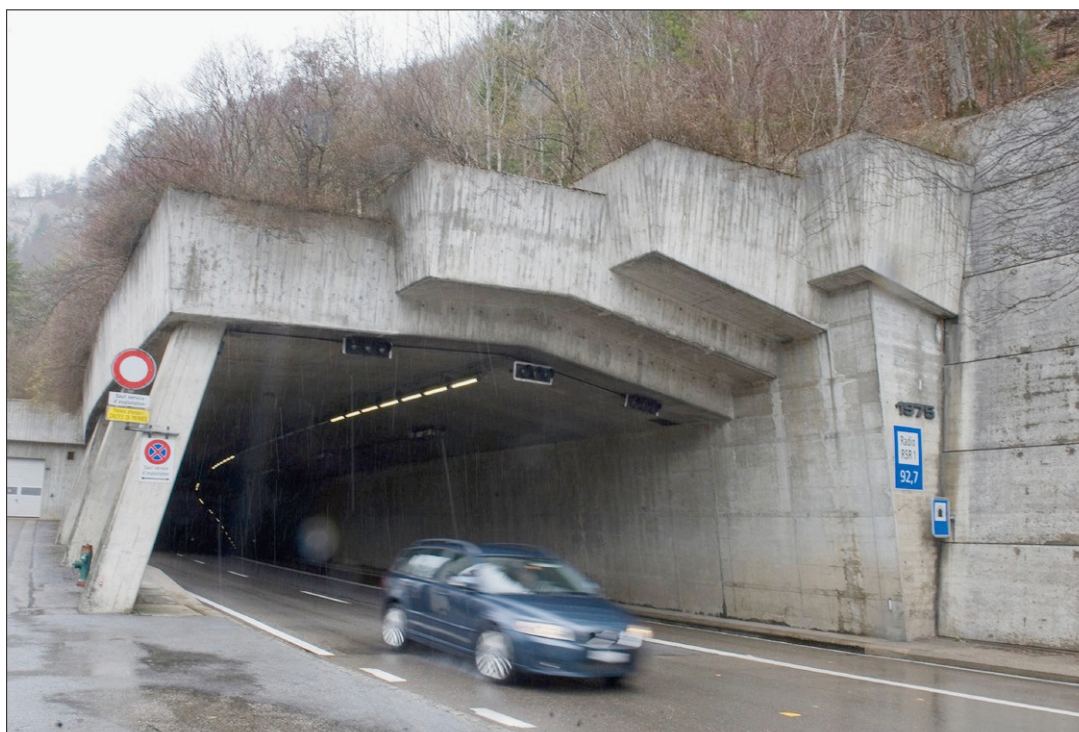
LA CLUSETTE Par choix, le tunnel n'a jamais été étanche. Par étourderie (?) tous les plans ne sont plus à disposition. L'Etat estime qu'il faudra investir entre 10 et 13 millions pour les réparations à mener. (DAVID MARCHON)
