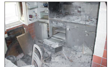
DÉGÂTS Les locataires ont dû être relogés.
