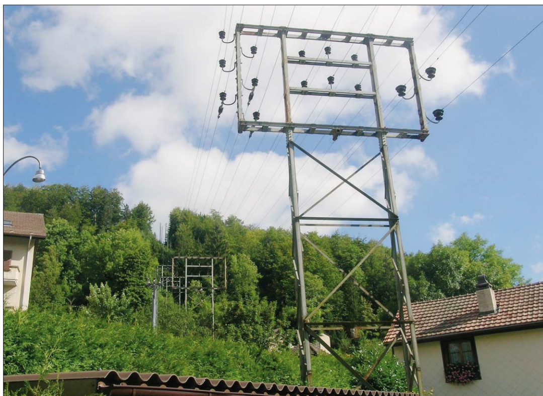
SOUS-STATION ENCORE AÉRIENNE Bientôt, cette forêt de lignes et de poteaux ne sera plus qu'un souvenir. La Goule entend ainsi mieux assurer la distribution de l'électricité à Saint-Imier.
