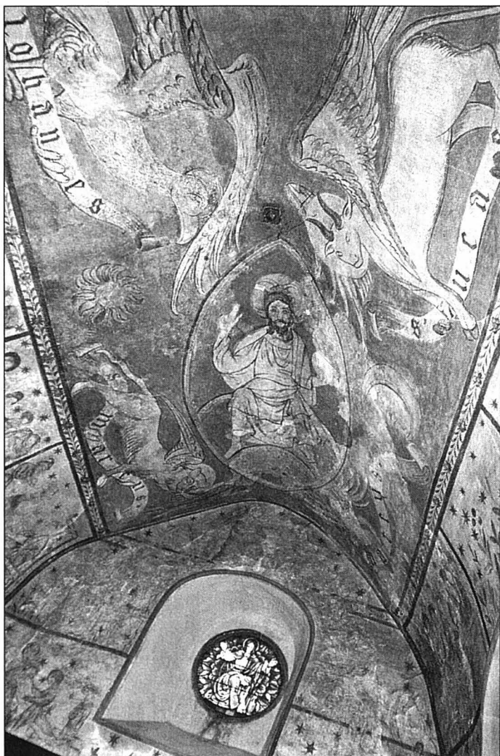
Les peintures médiévales de l'église d'Engollon se dégradent dangereusement. Ici la mandorle, représentant le Christ en gloire. PHOTO ARCH-LEUENBERGER
