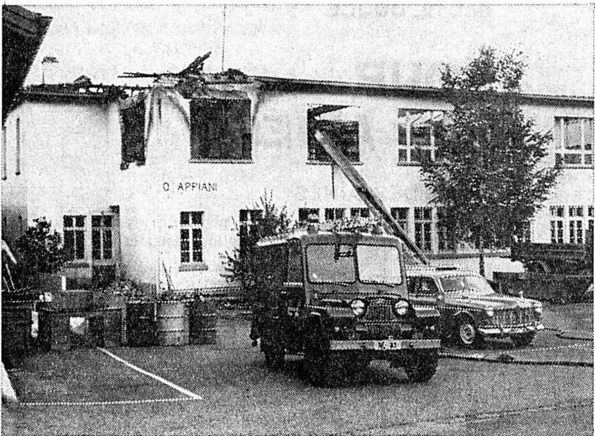
L'incendie qui a ravagé, dans la nuit de jeudi à vendredi, la fabrique Applan, a provoqué, à l'intérieur, d'importants dégâts, même si vu du dehors, le bâtiment paraît avoir peu souffert. (photo Colomb)
