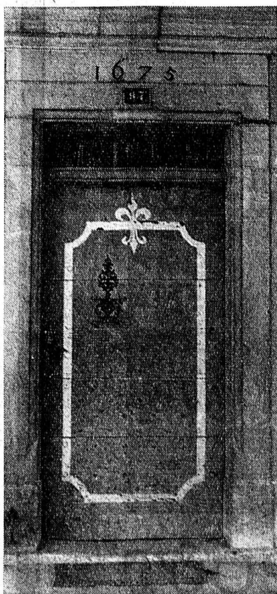
Ne pourrait-on pas obtenir des autorités locales qu'elles renoncent à enlaidir les portes de style en y inscrivant le numéro moderne de la maison ? (Photos Tissot)
